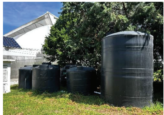
Figura 1. Tinacos plásticos de almacenamiento de agua de diversas capacidades para suministrar agua de riego a un invernadero. Texcoco, Estado de México.
